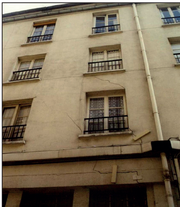
Fissuration d'une façade consécutive à une probable rupture des fondations
