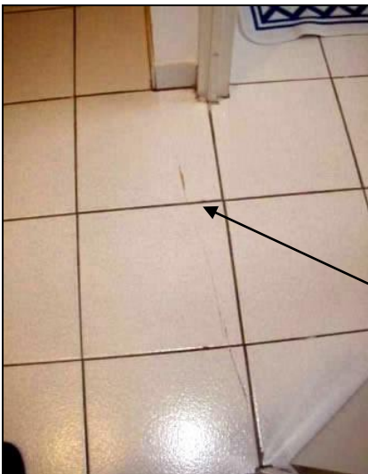
Fissure au niveau du seuil de porte, malgré la présence des joints de carrelage
