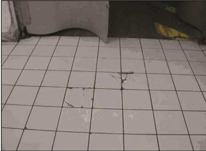
Désordres affectant le revêtement carrelé dus à un défaut de planéité du support
