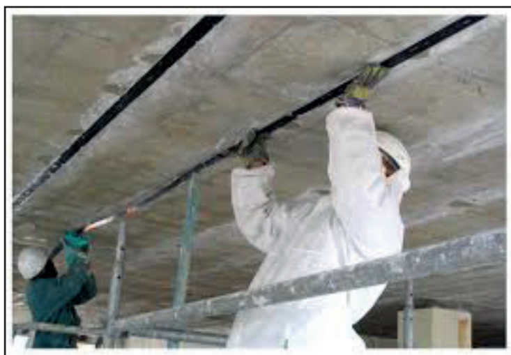
Renforcement d'une structure par la mise en œuvre de plats carbone (source SIKA)
