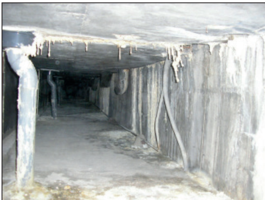
Défaut de conception : traversée d'un siphon de sol au droit d'une gaine de traitement d'air et défaut de calfeutrement du siphon de sol (Source GTM-Bâtiment)
