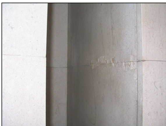
Rupture due à une concentration de contraintes (joints d'épaisseur trop faible)
