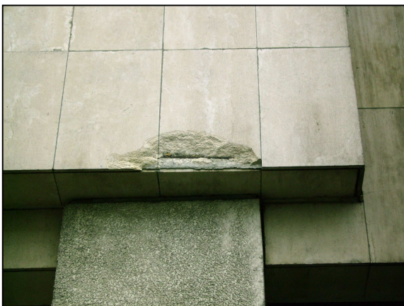
Eclats de la pierre en raison de l'oxydation des aciers
