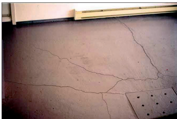
Fissuration de retrait au sein d'un dallage
