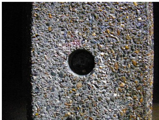
Décalcification du béton d'un poteau du bassin d'une usine de traitement des eaux au après filtration [11]
