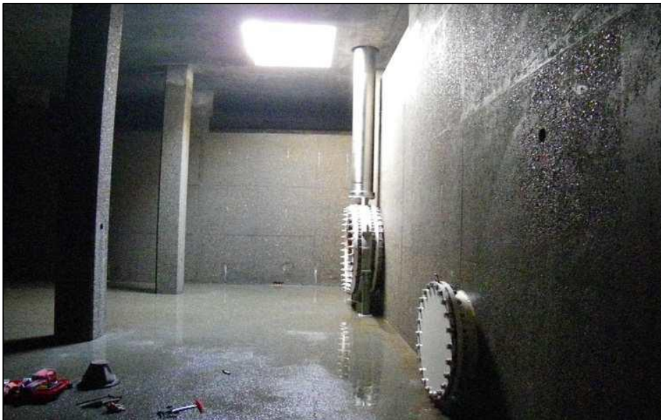
Décalcification du béton des parois des bassins
