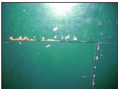
Dégradé (fissuration, faïençage)
