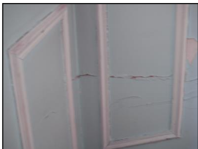
Dégradé (fissuration, écaillage)
